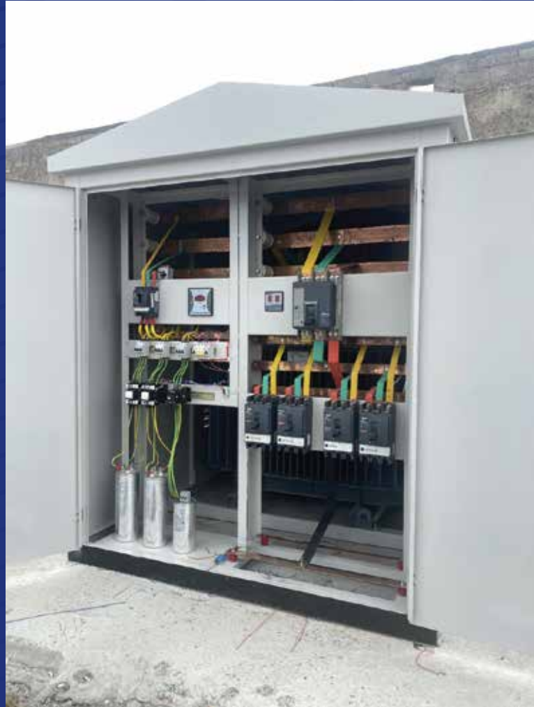
630/10/ 0/4 kVa gücündə transformator məntəqəsinin 0.4KV-luq hissəsi
