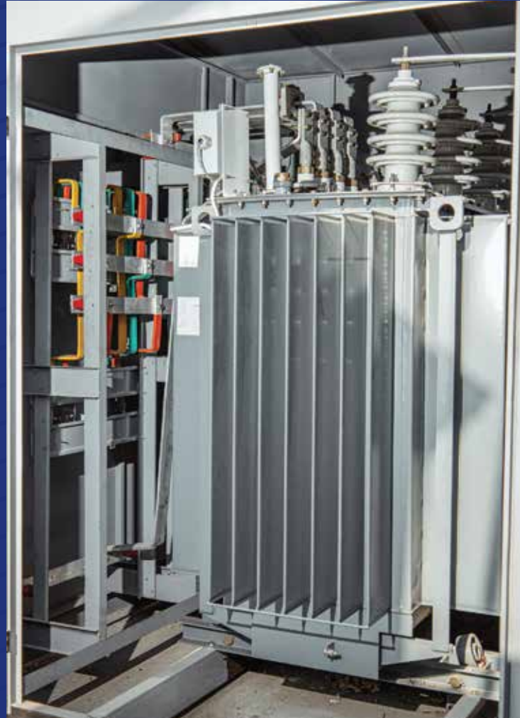
35 kV-luq 1000 kVa KTM-si
