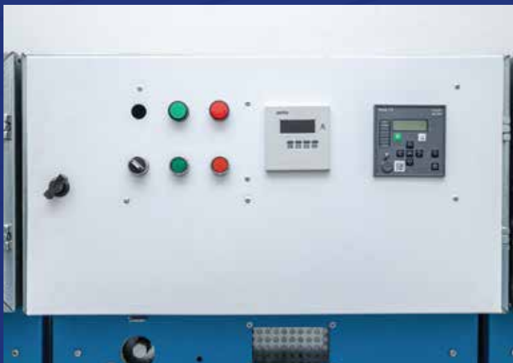
Yeni tikilmiş transformator məntəqəsində 10 kV-luq yuvalar
