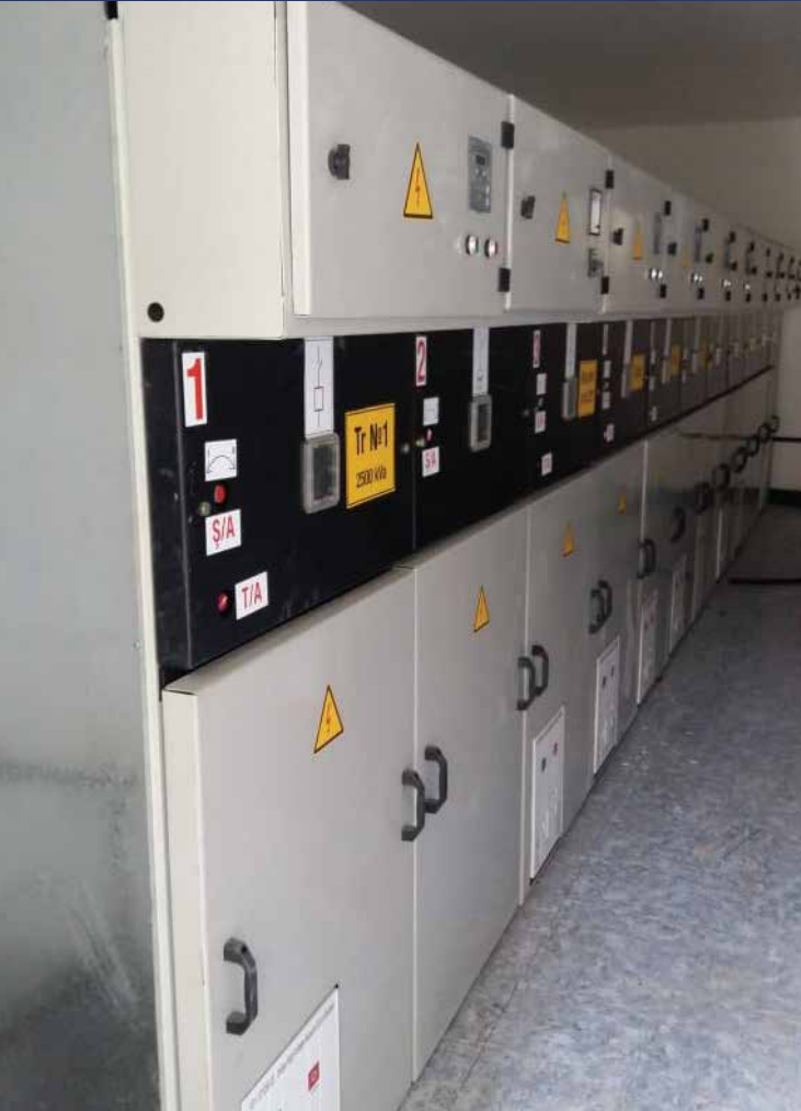
Yeni TM-də 6 kV-luq hissə
