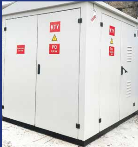
630/10/0.4 kVa gücündə transformator məntəqəsi
