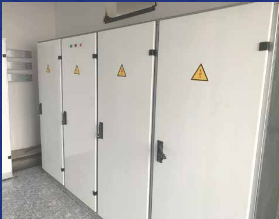
Yeni TM-də 0.4 kV-luq hissə
